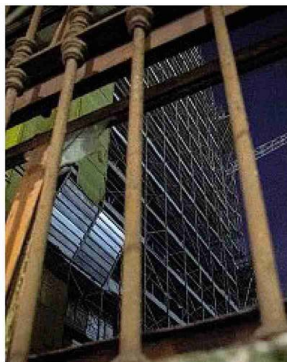
Viale Richard Tra i cantieri sotto inchiesta della società indagata Abitare In due sono sui Navigli: Porta Naviglio Grande in viale Richard (foto) e Palazzo Naviglio in via privata Lodovico Pogliaghi
